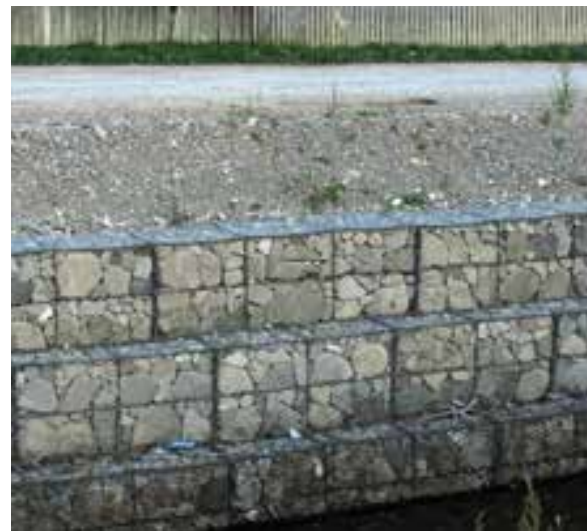
A patakok parterősítése (kikövezése) tovább fokozza a meder már eddig is előrehaladott bevágódását
